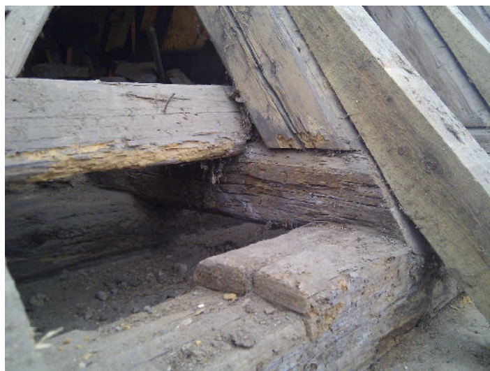
Alter Schädlingsbefall am Balkenkopf
