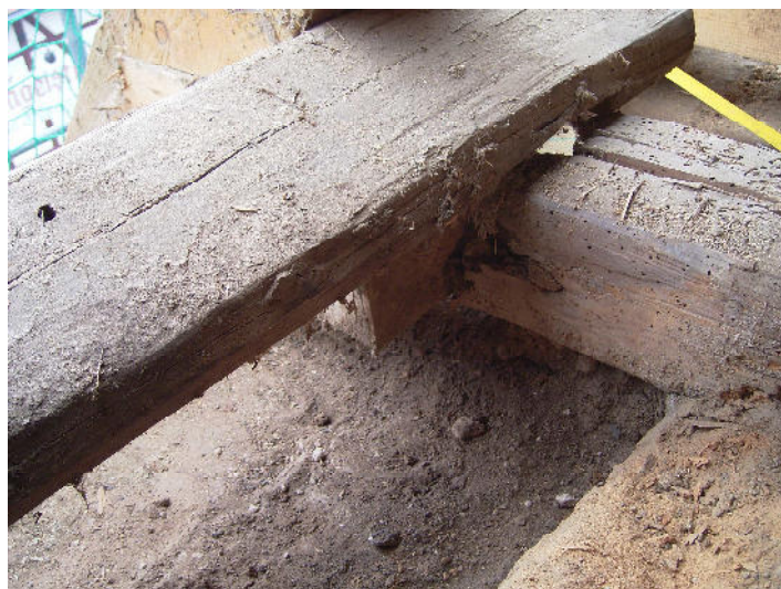
Balkenkopf mit Schädlingsbefall
