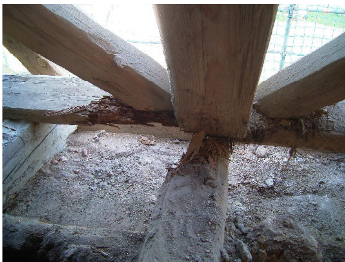
Stuhlschwelle mit Schädigungen auf der Nordseite
