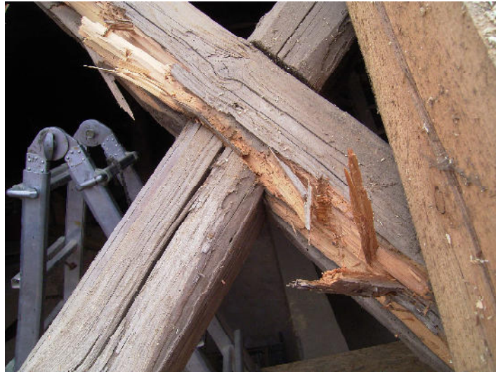
Schädlingsbefall an den Stuhlstreben
