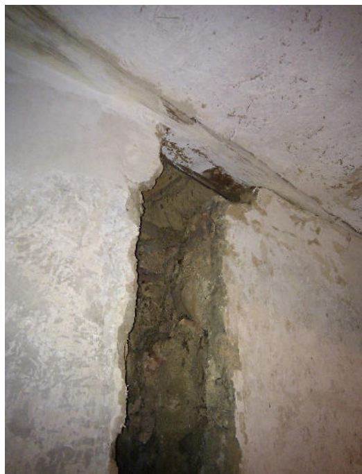
Fehlender Anschluss im oberen Bereich
