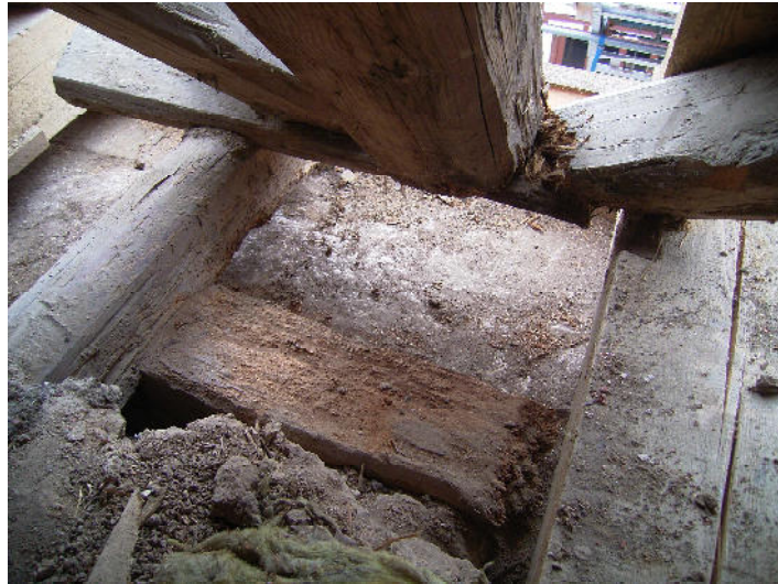
Stuhlstreben im Fuß stark geschädigt
