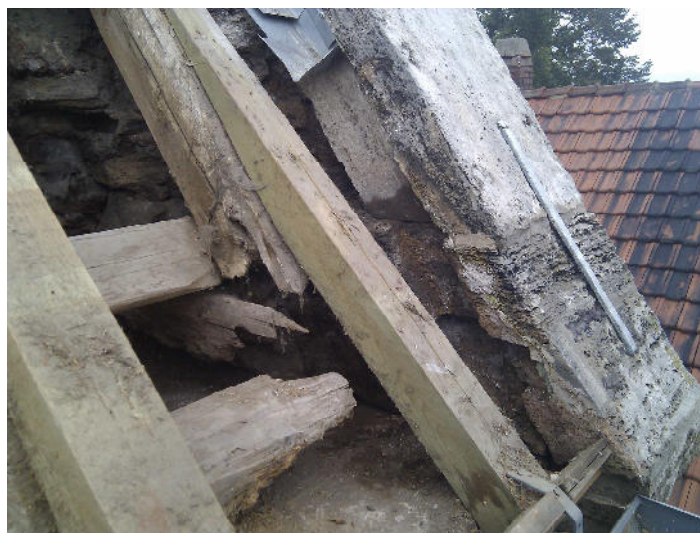
Zerstörter Sparrenfuß an der Süd – Ost – Ecke
