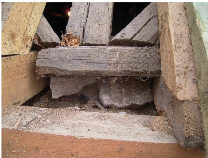
Stuhlschwelle wurde nicht mehr eingebaut
