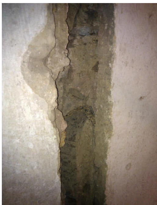
Loch in der Wand, in dem ursprünglich der Riegel war
