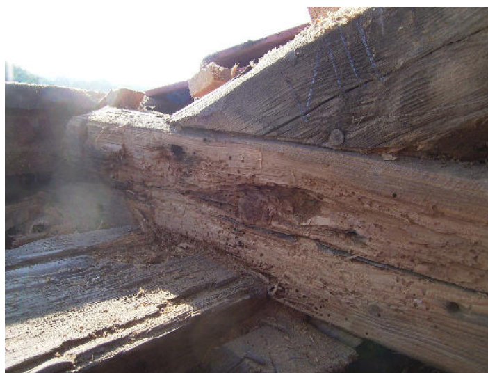
Schädlingsbefall am Balkenkopf
