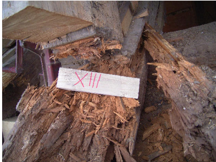
Schädigungen am Binder 13
