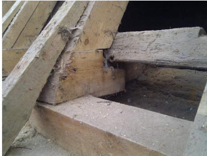
Zerstörter Balkenkopf Nordseite
