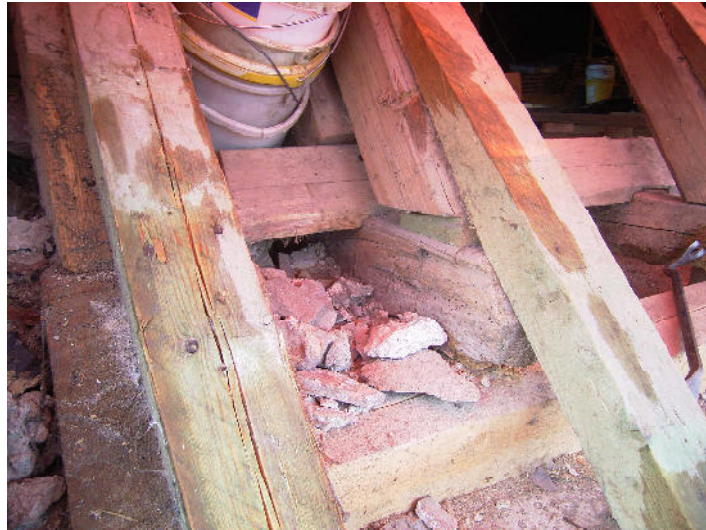
Schutt wurde nicht ausgeräumt
