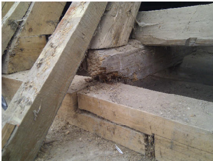
Neue Hölzer wurden unter zerstörte Balken gelegt ohne sie zu verbinden.
