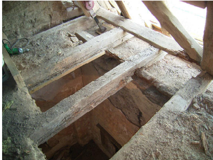
Schädigungen an der inneren Mauerlatte Nord – West – Ecke
