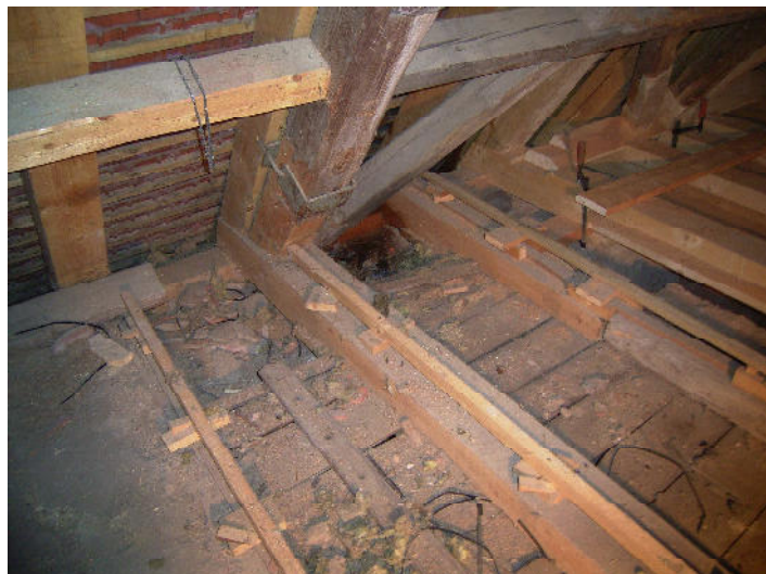
Zu kurzes Blatt wurde mit einer Stahlklammer gesichert
