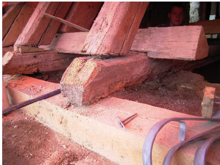
Keine Verkämmung der Balken vorhanden
