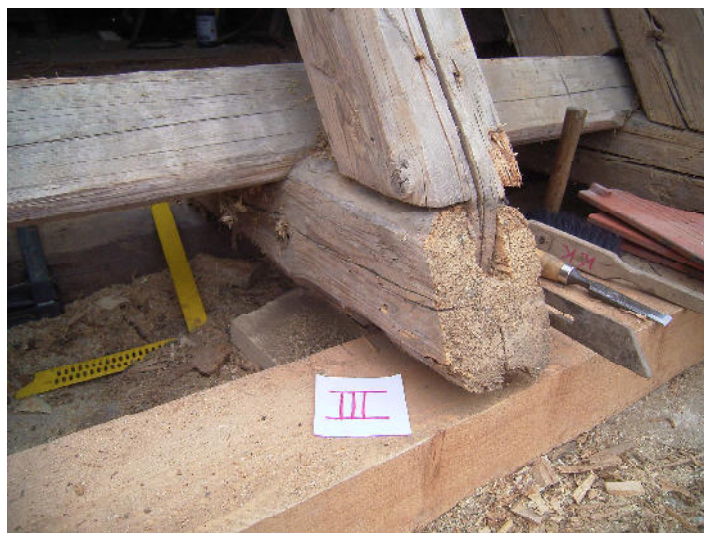
Kein Vorholz vorhanden am Deckenbalken
