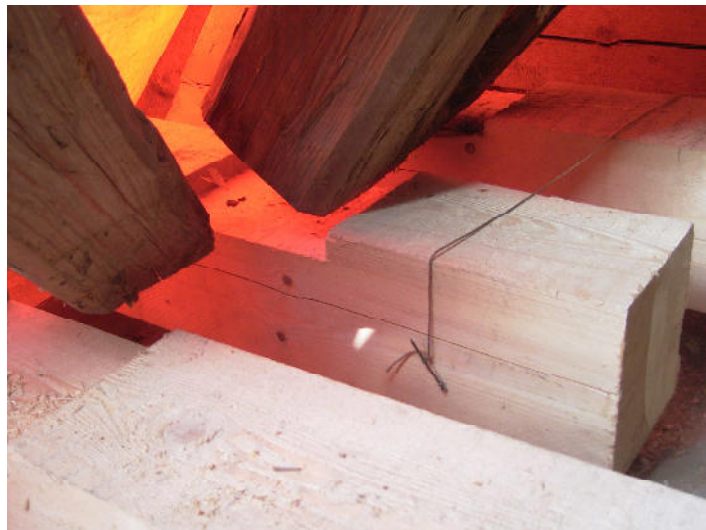
Zusätzlich eingebauter Stichbalken, der aus statischen Gründen zusätzlich eingebaut wurde. An dieser Stelle war kein Deckenbalken unter der Stuhlsäule vorhanden, obwohl eine große Last auf die Keilschwelle übertragen wird. Der neue Stichbalken wirkt größeren Verformungen entgegen.
