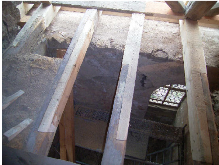
Balkenanblattung an der Südseite
