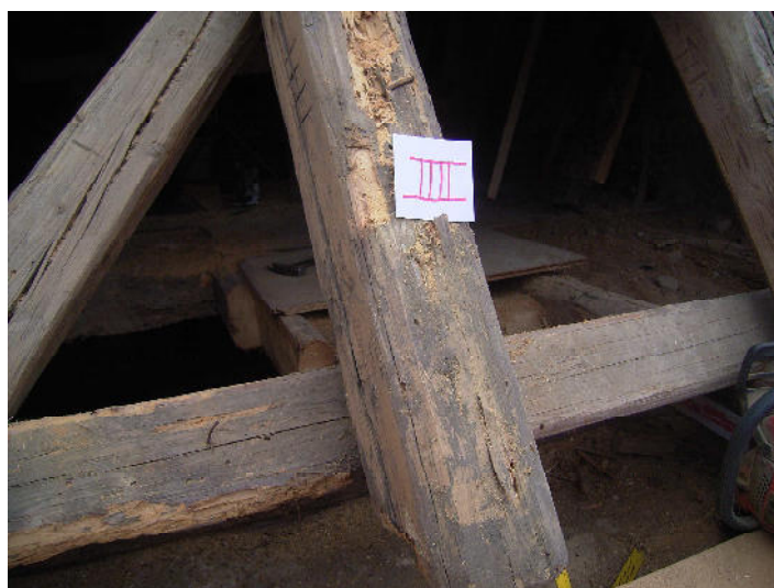
Schädigungen auf der Sparrenoberseite
