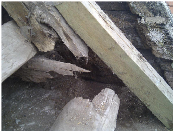
In der Süd – Ost – Ecke war die Mauerlatte zerstört
