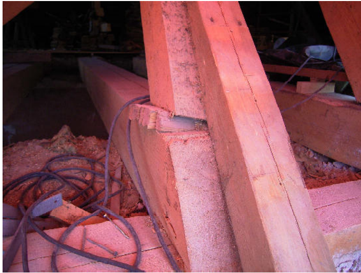
Balken wurden ohne Holzverbindungen eingebaut, mit Nägeln befestigt und mit Holzkeilen unterfüttert.
