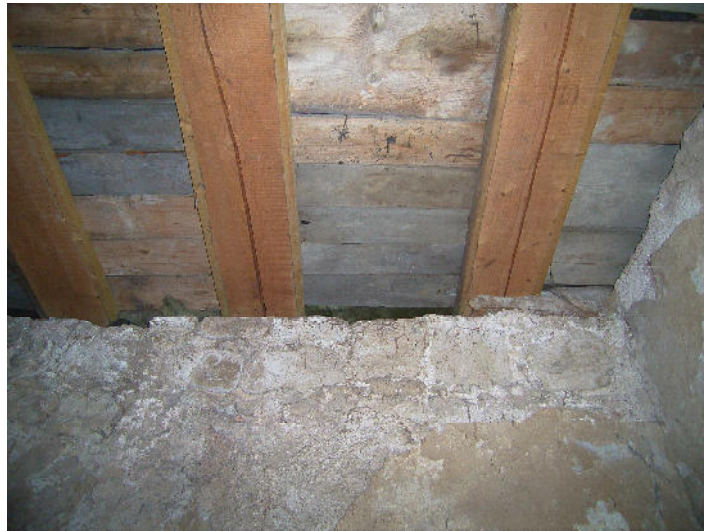
Innere Mauerlatte nicht mehr vorhanden
