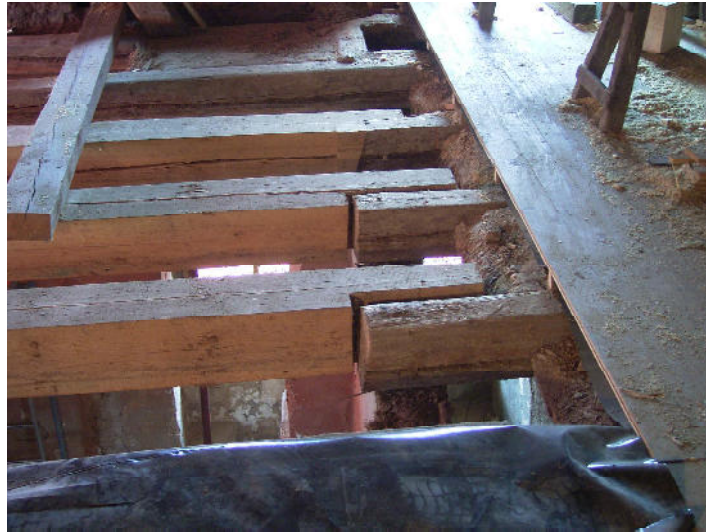
Vorhandene Balkenstöße über Raum 1.9 ohne Verbindung
