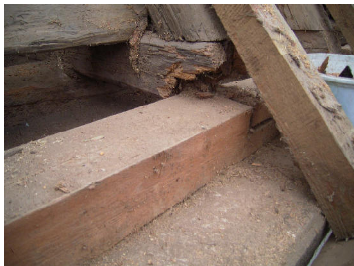
Balkenkopf über der äußeren Mauerlatte zerstört
