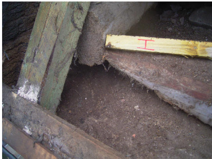
Schädigungen der äußeren Mauerlatte an der Ostseite
