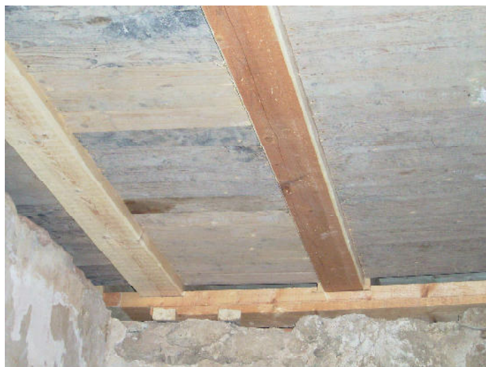
Neue Deckenuntersicht mit Fehlboden und Ausklinkungen an der Balkenunterseite
