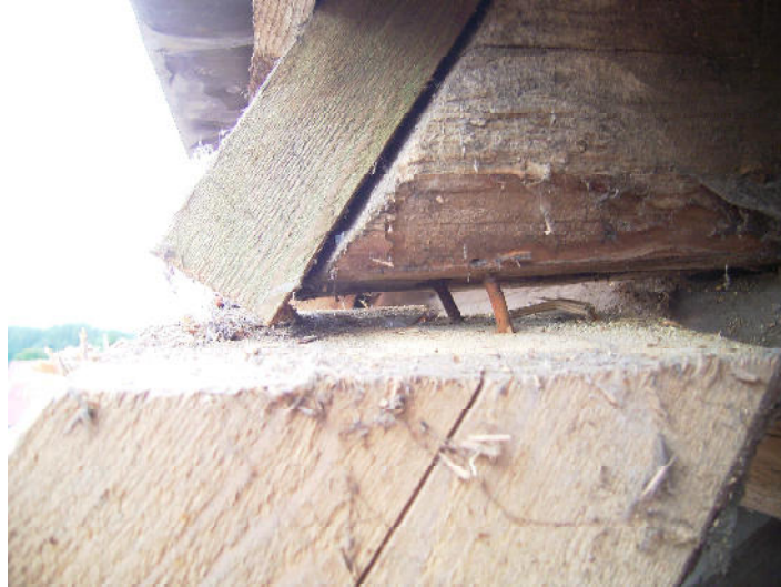
Sparren an der Oberseite ohne kraftschlüssige Verbindung
