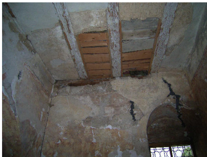
Innenansicht zerstörte innere Mauerlatte
