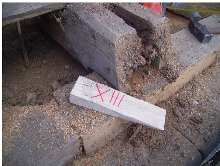
Keine Längsverbindung an der äußeren Mauerlatte.
